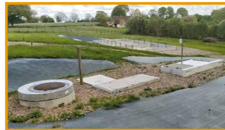
La station d'épuration de Saint Jean-de-la-Forêt
